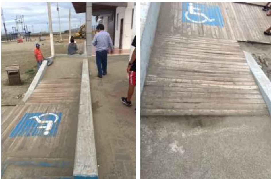
Figura Nro. 38 Rampa mixta hormigón y madera en la parte inferior de ingreso a la caminera de madera instalada en la playa “El Murciélago”.
