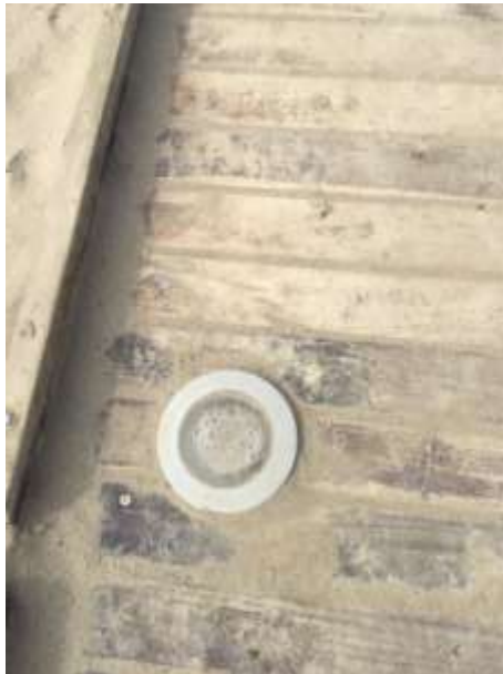
Figura Nro. 32 Estado actual de luminarias y materiales de la caminera de madera playa “San Mateo”.
